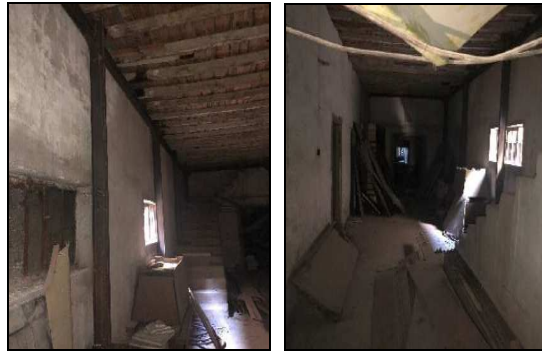
Şekil 35. Ahşap kirişli döşemde sehim, çürümeye ile metal elemanlarda korozyona bağlı oluşan hasarlar
