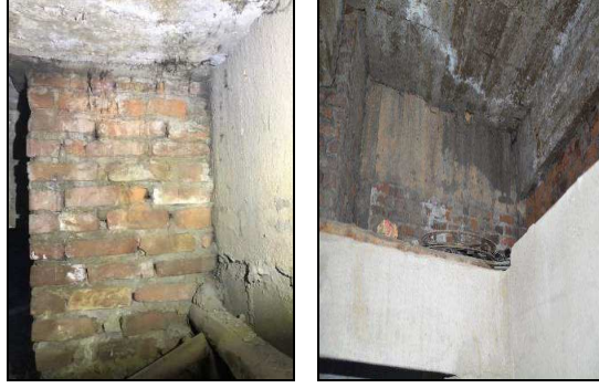
Şekil 25. Makine dairesinde neme bağlı oluşan bozulmalar
