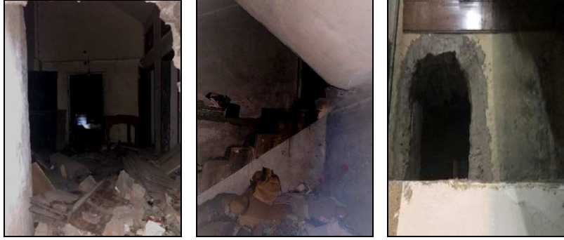
Şekil 33. Site Sineması merdiven ve duvarlarda malzeme kaybı hasarları
