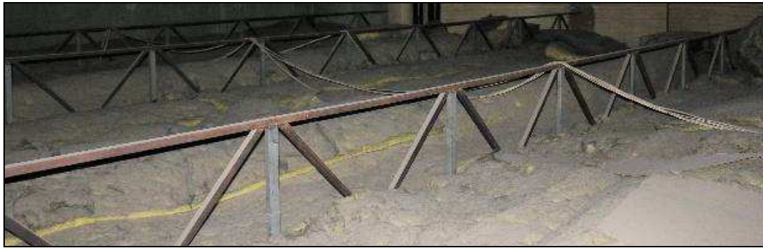
Şekil 21. Kapatılan loca katı döşemesinde oluşan bozulmalar
