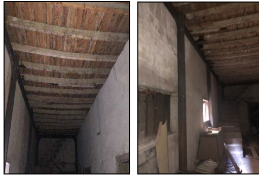
Şekil 29. Site sinemasında ahşap kirişlerde sehim hasarları
