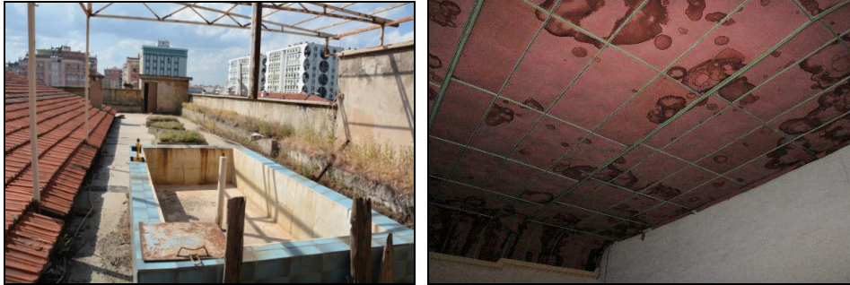
Şekil 23. Dilan Sineması Salon 1 tavan kaplaması ve kolondaki neme bağlı bozulmalar
