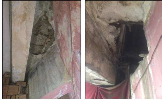
Şekil 16. Salon 1 makine dairesinde en yüzey ve doku kaybı hasarları
