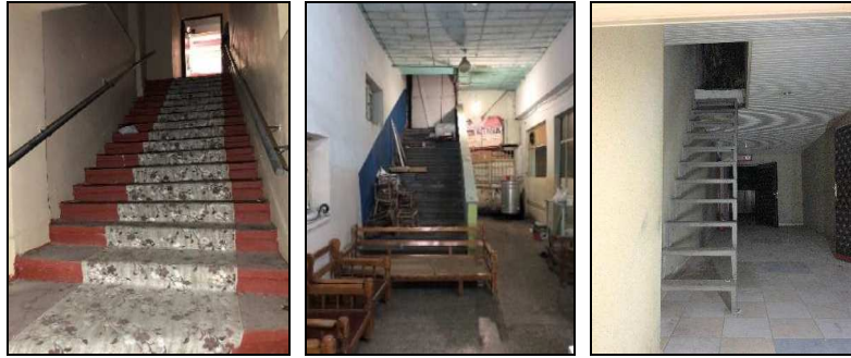
Şekil 34. Site Sinemasında kapatılan merdiven ile makine dairesine eklenen metal merdiven
