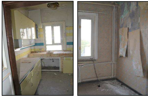
Şekil 24. Lojman ve misafirhanede neme bağlı oluşan bozulmalar
