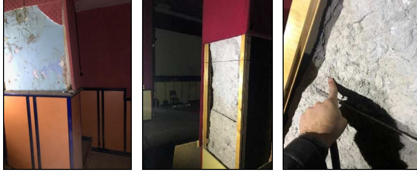
Şekil 13. Taşıyıcı Kolonlarda oluşan korozyon, sıva kaybı ve kesit daralmasına bağlı sorunlar
